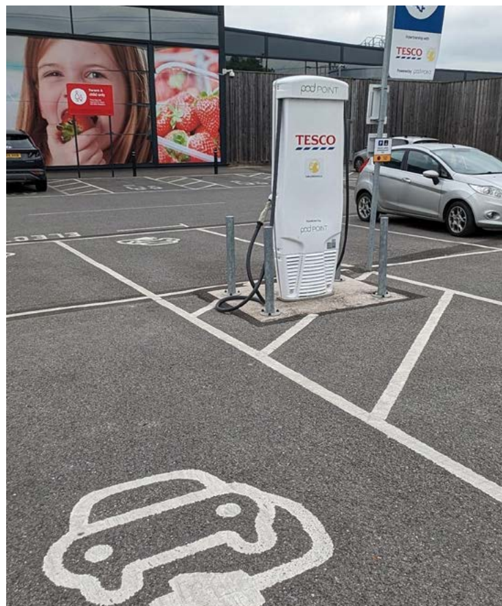
EV chargers, Tesco Superstore, Calne
