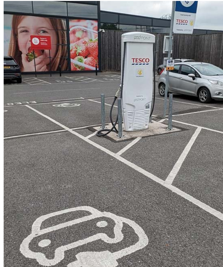
EV chargers, Tesco Superstore, Calne
