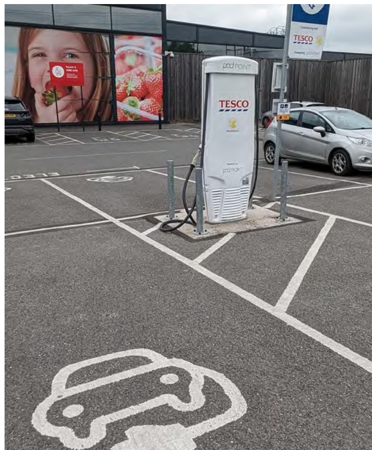
EV chargers, Tesco Superstore, Calne
